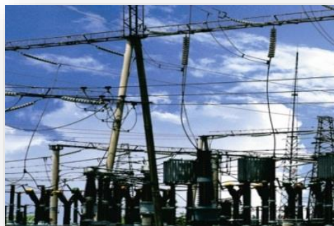
電力システム
